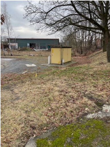
Gasregelstation im Bereich der Mischgebietsfläche
